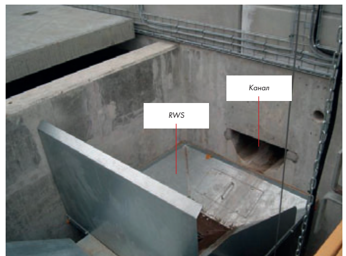
Зона передачи материала из лотка на установку RWS
